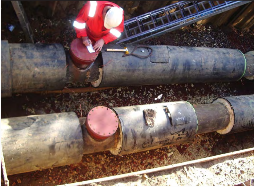
Bild 4. Absperrfittings auf dem Vor- und Rücklauf
