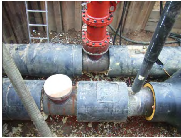
Bild 9. Blindflansch (l.), Stopple-Gerät (m.) und Druckentlastungsanschluss (r.) zukünftig als Entlüftungsstutzen genutzt
